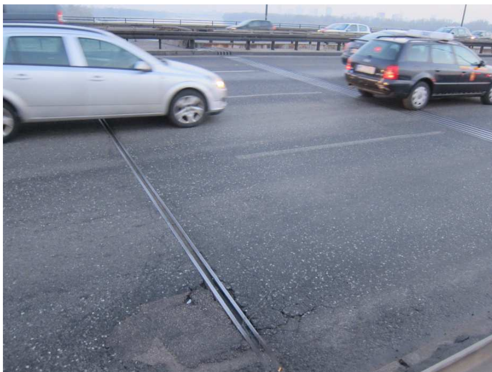
Rys. 3-17. Spękania, ubytki mieszanki mineralno-asfaltowej oraz źle wykonana łąta w obrębie dylatacji
