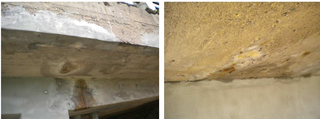
Rys. 3-4. Przykłady zniszczeń dolnej powierzchni płyty betonowej mostu na Biebrzy
