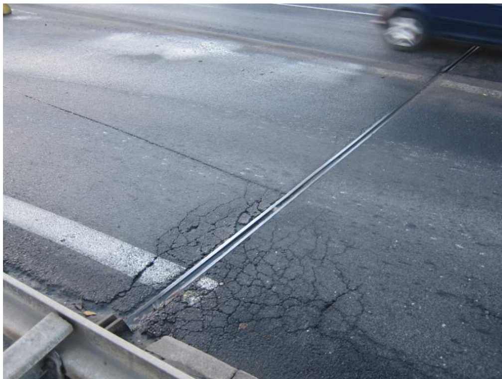
Rys. 3-9. Spękania siatkowe w obrębie dylatacji
