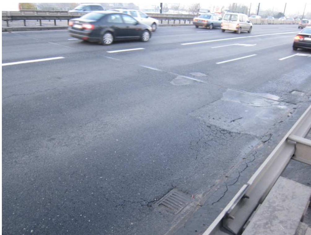
Rys. 3-13. Łata ze spękaniami oraz spękania siatkowe w obrębie kratki ściekowej
