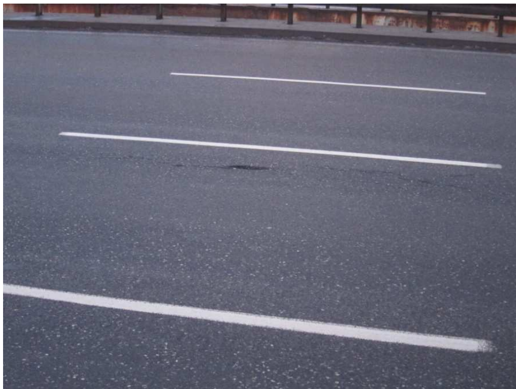
Rys. 3-16. Spękanie podłużne z ubytkiem mieszanki mineralno-asfaltowej
